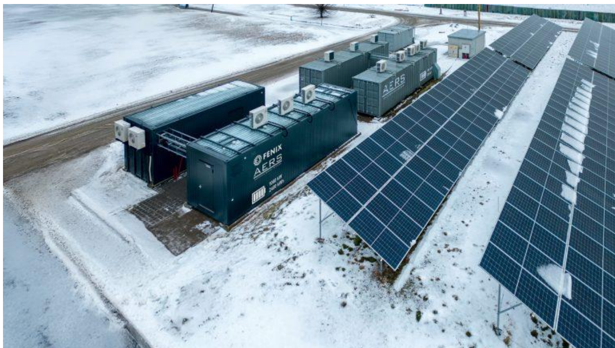
SAS 3 Velkokapacitní bateriové úložiště pro poskytování služeb výkonové rovnováhy
